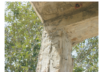
Dislocation de la tête du poteau
