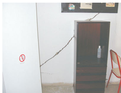
Fissure inclinée importante
