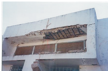
Dalle en porte-à-faux en chute
