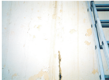
Fissuration au niveau du joint
