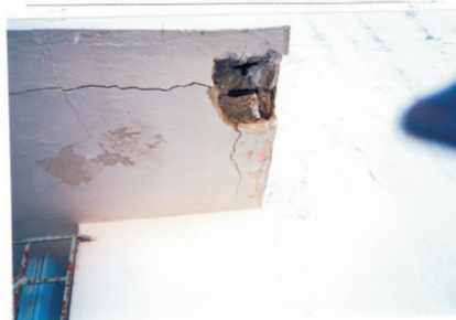
Fissures profondes et aciers apparents
