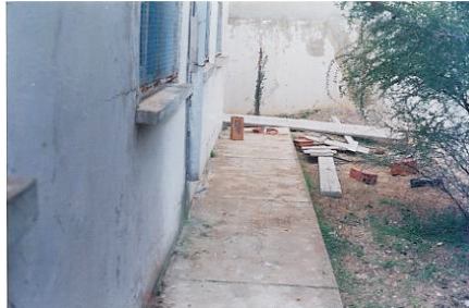
Fissures profondes et mauvaise étanchéité
