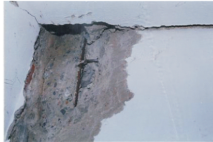
Cisaillement du raidisseur bordant le plancher de la salle nord: raidisseur chanfreiné et armatures dénudées.
