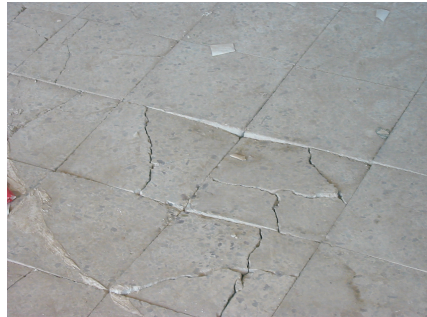
Déflexion du revêtement du RDC
