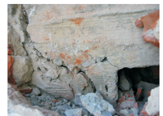
Ecrasement du poteau au noeud d'intersection
