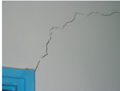
Fissure inclinée à l'angle de la porte
