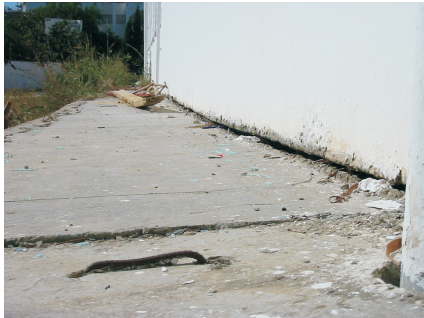
Affaissement du trottoir
