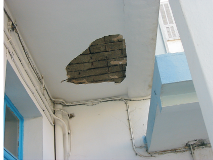
Plancher dégradé et risque de chute
