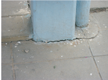
Poteau affaissé et revêtement dégradé
